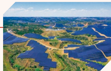
欧洲单体装机容量最大的 光伏电站
