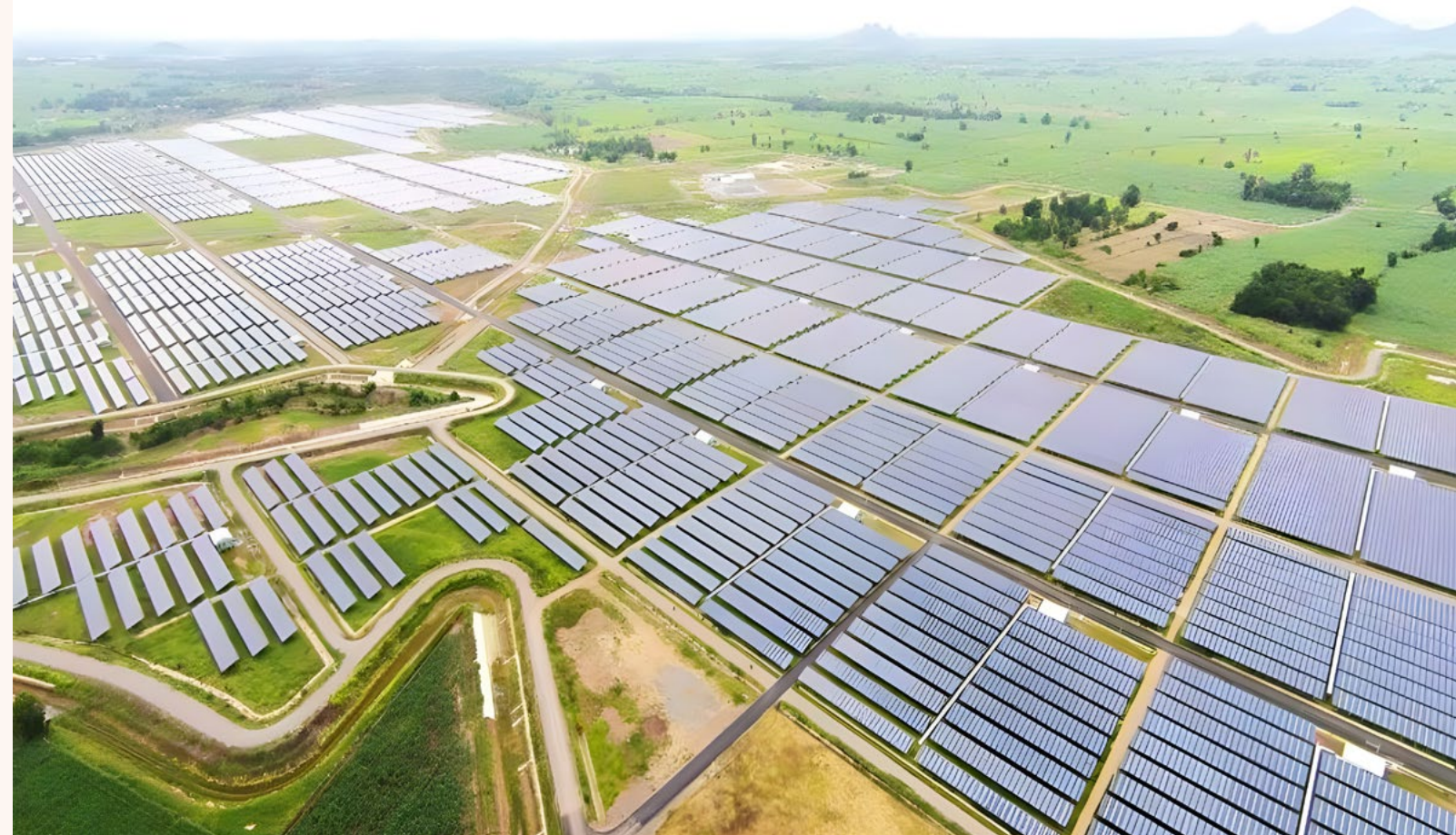
泰国 PHISANULOK 133.9MW 地面光伏电站
